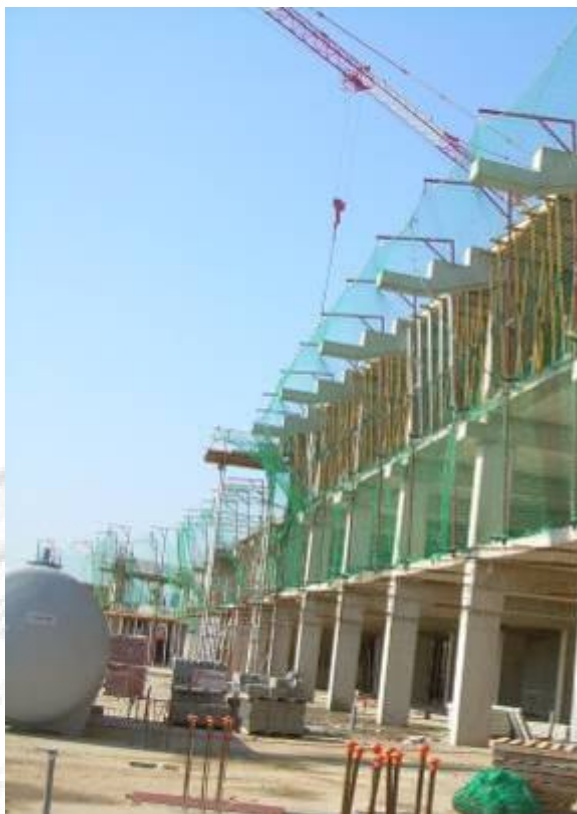
Vista de les xarxes verticals de protecció en forjats de l'estructura.
