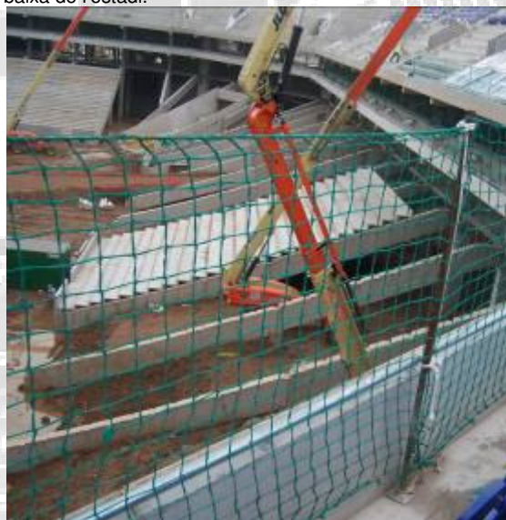
Vista de les xarxes verticals de protecció tipus tennis en els perímetres de la grada alta de l'estadi.
