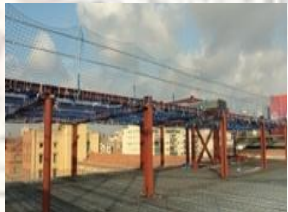
Vista de les proteccions de seguretat en vores de forjat i voladissos de l'estructura d'acer.
